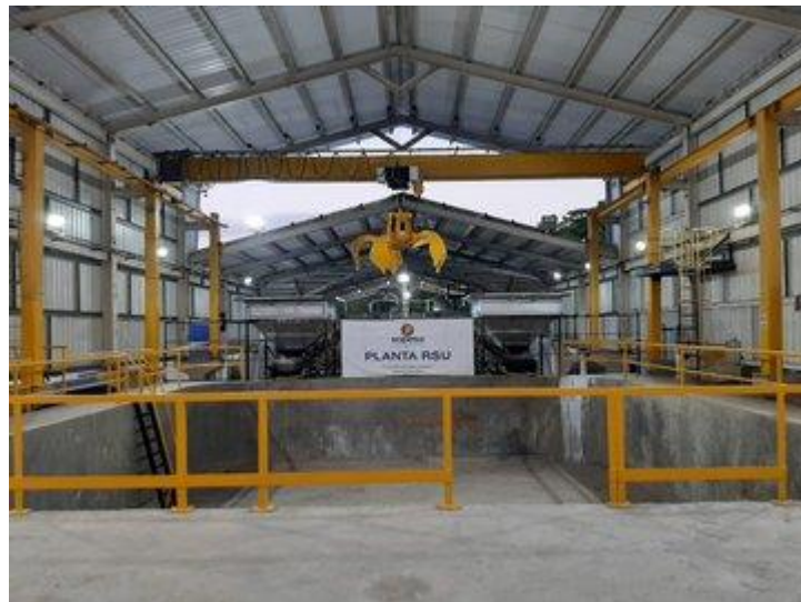
Figura 101. Planta de residuos sólidos urbanos en la isla de San Andrés [21].
