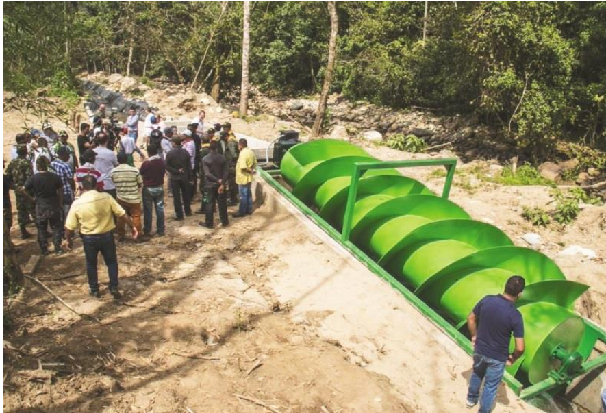
Figura 47. Central hidroeléctrica de Pico con tornillo de Arquímedes en Miravalle, Meta [15].
