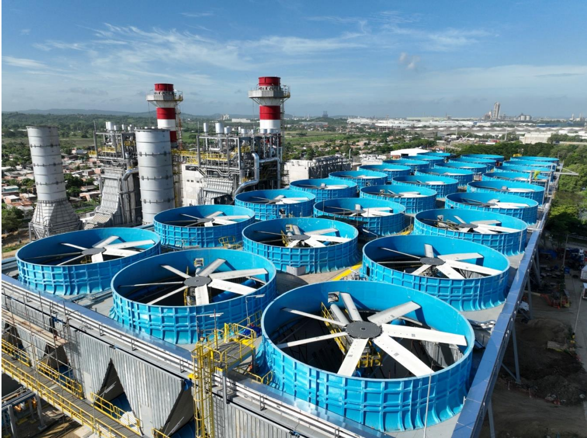
Figura 86. Central de Ciclo Combinado de Termocandelaria [15].
